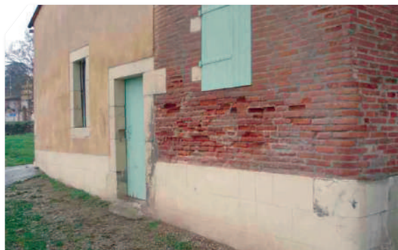
▲ Exemple de désordres liés aux remontées d'humidité sur des briques apparentes
